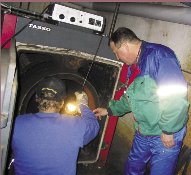
HEIKKI NIKKONEN JA JUKKA KIESILÄINEN TARKASTAMASSA ÖLJYKATTILAA
